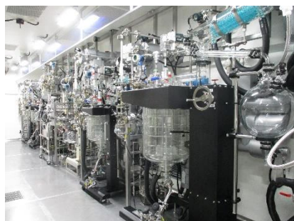
図 1. プッシュプル換気設備を有した製造室 （反応槽、ろ過機、ロータリーエバポレーター）
