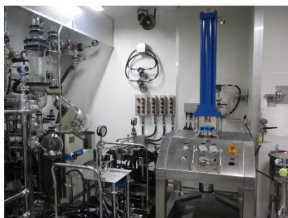
図 2. プッシュプル換気設備を有した製造室 （可動栓カラム）
